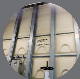
給排水衛生設備
